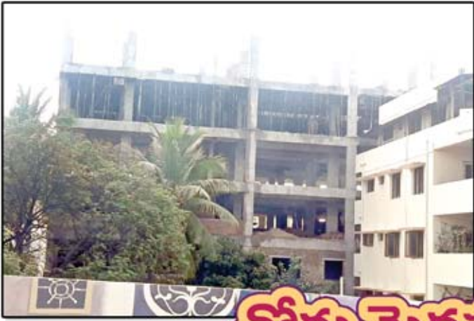
అంబేద్కర్ పైఠావర్ ప్రిడ్జి ఎక్కేటప్పుడు రైట్ సైడ్ చూస్తే 7 అంతస్తులతో బహుళ భవంతి, నగరపాలక నిబంధనల విరుద్ధంగా అదనపు నిర్మాణాలు..
